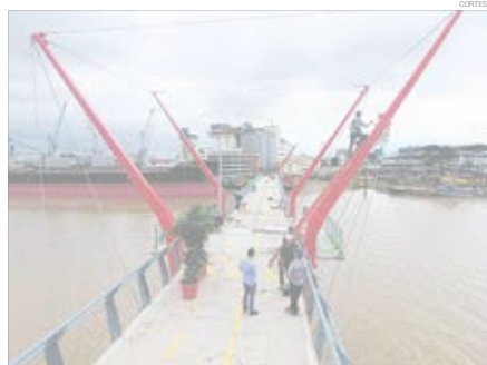
Labores. Así se observaba la tarde de ayer a los obreros que ejecutaban retoques finales al viaducto hacia Santay.
